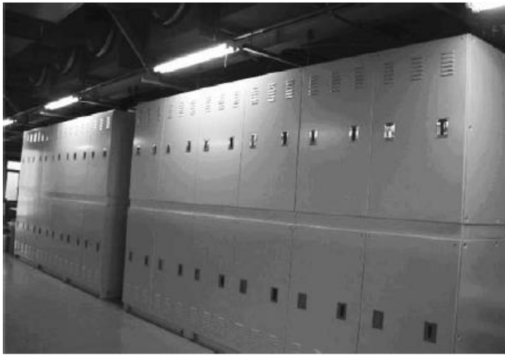
写真1 負荷平準化用 500kWシステム (電池盤)
